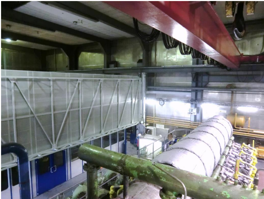
Trennwand in heruntergefahrenem Zustand. Rechts oben ist der Hallenkran zu erkennen.
